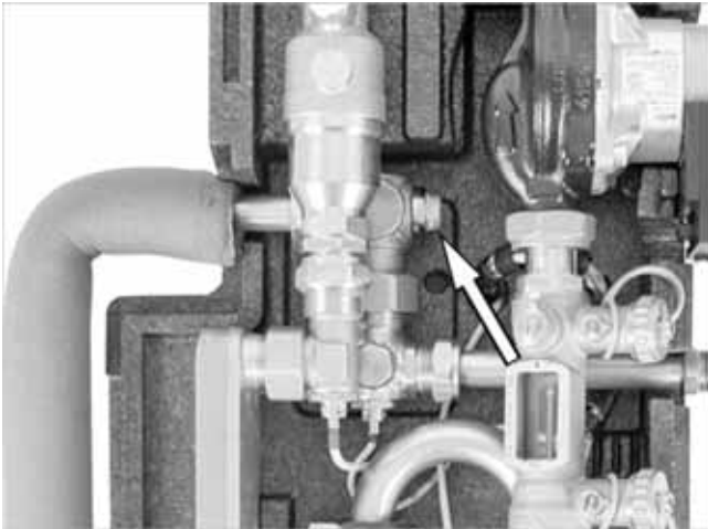
Fig. 16: Sfiatatoio manuale del lato secondario
