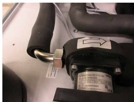
Collegamento di ritorno della pompa di calore
