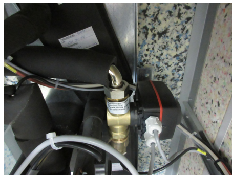
Collegamento di mandata della pompa di calore
